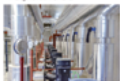
1 Sala de máquinas (IP21). Engine room (IP21)
