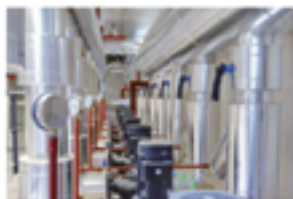
1 Sala de máquinas (IP21). Engine room (IP21).
